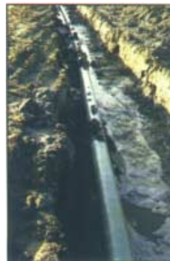
Kazakhstan – 1999 Tubería de Conducción SSS de 8" a 1000 lbs/plg 2 , 30,479 m
