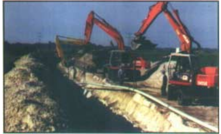
Línea de Conducción de gas amargo en 6" a 2000 lb/plg 2 hasta 2001, desde entonces inyectando agua salada - Holanda
