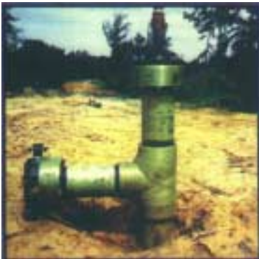
Tee de 8"- Válvula de Venteo Tie Down de 6" a 500 lb/plg 2 , Mississippi
